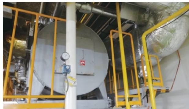
排ガス処理装置
