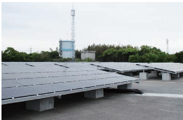
太陽光発電施設
