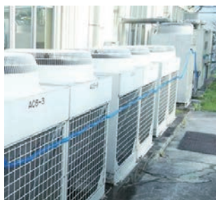
室外機への散水
