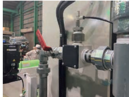
ノリタケ濾過装置機内循環ラインに設置。 Installed in the circulation line of filtration system
