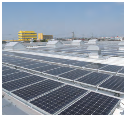
太陽光発電設備（小牧工場） 太阳能发电设备（小牧工厂）
